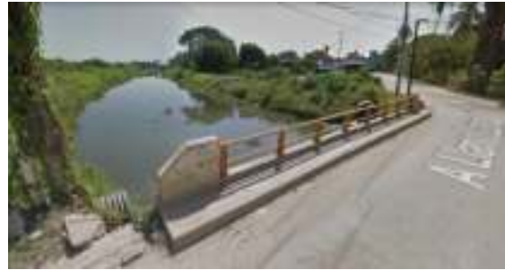
Canal localizado en el Sector VI que se incorpora al Sector V
